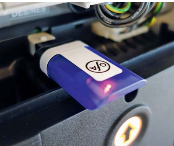
Den GfA-Stick stecken Anwender an die Torsteuerung an und ermitteln so wichtige Betriebsdaten der Anlage. Fotos: GfA
